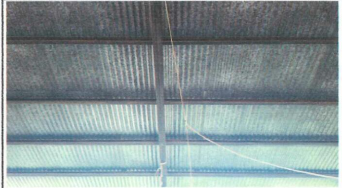
Foto 2: MANTENIMIENTO A ESTRUCTURA DE TECHA EN MAL ESTADO
